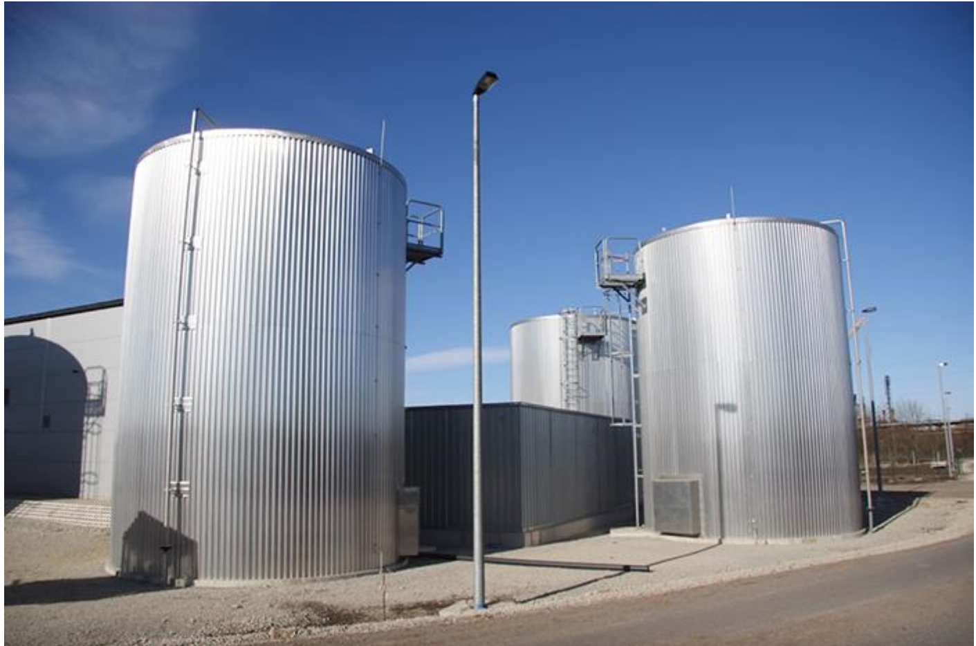
Pasteurisation plant in Kohtla-Järve, Estonia. Photo: OÜ Järve Biopuhastus.
