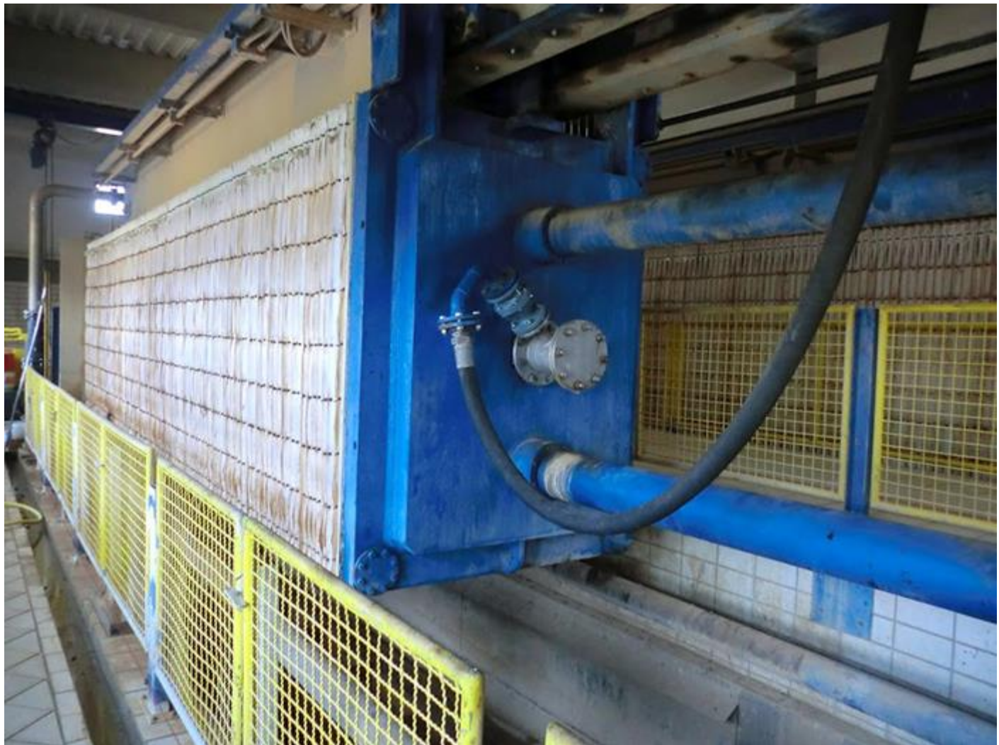
Chamber filter press in Lübeck, Germany. Photo: Entsorgungsbetriebe Lübeck.
